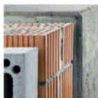
Искусственный камень, неармированный бетон, бордюрный камень, кирпич
